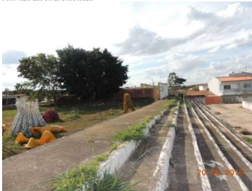
Foto: parte do muro interno que caiu
