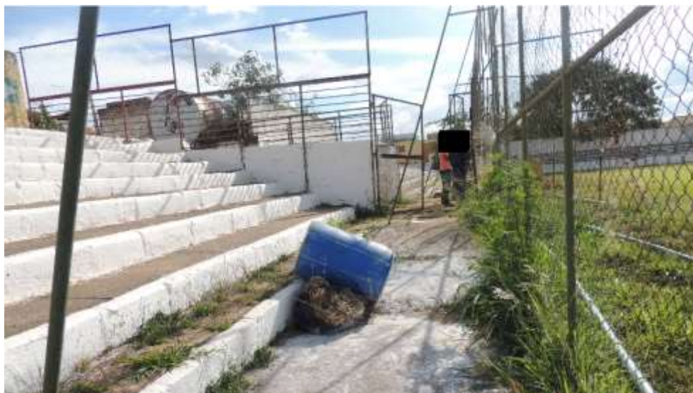
Foto: entulhos na área de acessos de pessoas
