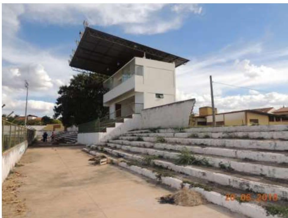
Foto: vista de parte do muro que caiu
