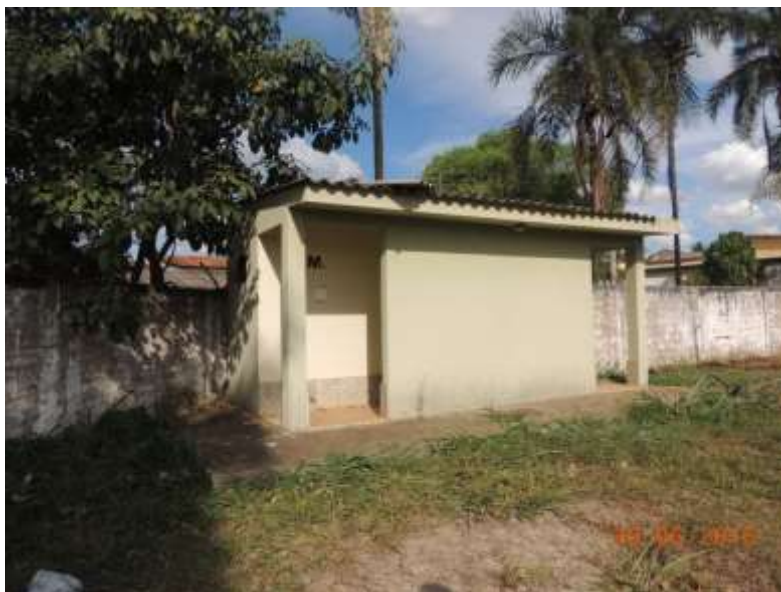
Foto: aspecto de abandono na entrada dos banheiros
