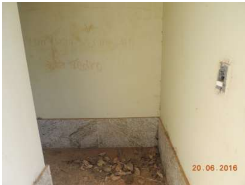
Foto: interruptores do banheiro sem a capa de proteção
