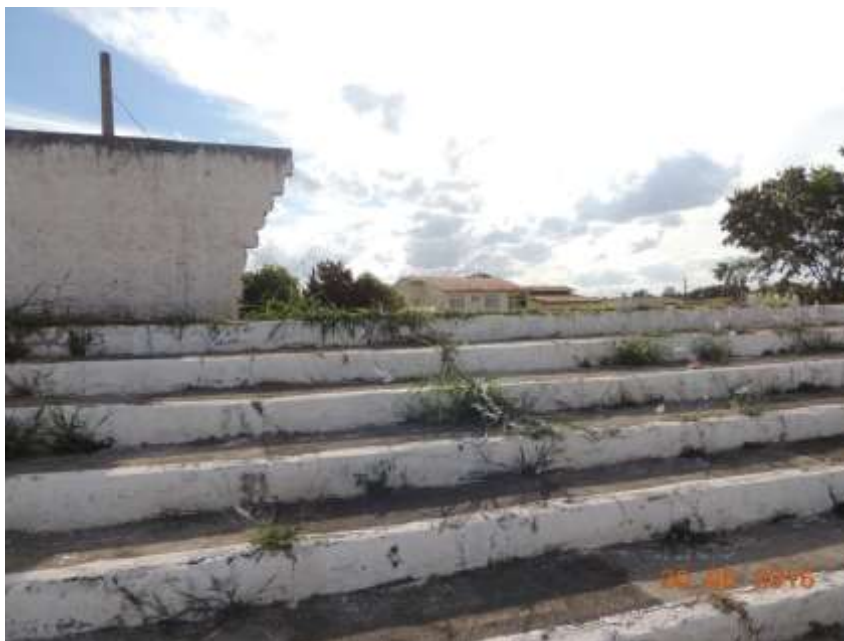
Foto: outro ângulo do muro que caiu
