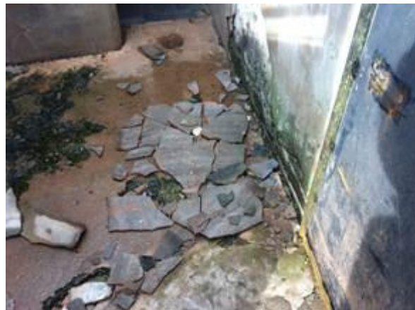
Baias em péssimo estado de conservação
