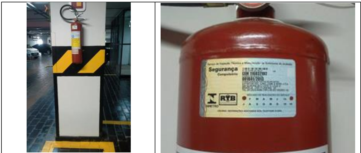
Extintor vencido em janeiro de 2015 na garagem do Palácio do Buriti
