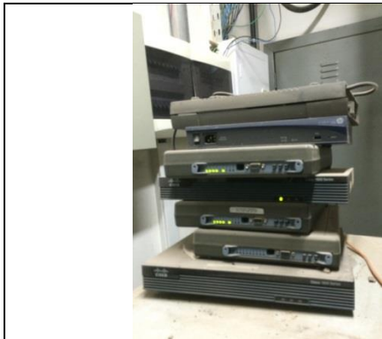
Figura 12 - Modems sem a fixação nos racks, causando risco de acidentes a todos os equipamentos. Foto tirada em 27/07/2016.
