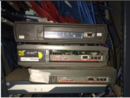
Figura 6 - Modems acomodados sobre o roteador, causando risco de acidentes a todos os equipamentos. Roteador sem identificação. Foto tirada em 02/06/2016.
