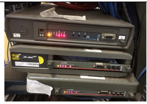
Figura 9 - Identificação precária e ausente dos modems acomodados sobre o roteador, o que dificulta a gestão dos ativos em caso de manutenção e incidentes. Foto tirada em 02/06/2016
