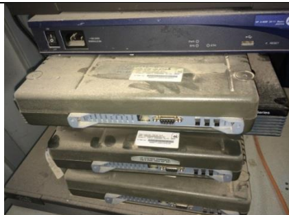
Figura 14 - Ausência de identificação dos circuitos de dados e acondicionamento incorreto dos equipamentos (roteador e modems), expondo os mesmos a acidentes ação de poeira e umidade. Foto tirada em 27/07/2016.
