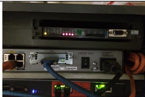
Figura 11 - Modems sem a fixação nos racks, causando risco de acidentes a todos os equipamentos. Foto tirada em 02/06/2016.
