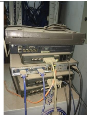
Figura 13 - Cabeamento e Modem sem identificação, o que causa risco de acidentes na manipulação além de dificultar a manutenção e intervenção em caso de incidentes. Foto tirada em 27/07/2016.
