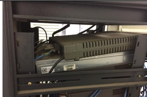
Figura 7 - Modem acomodado sobre outro equipamento, o que causa risco de acidentes e compromete a segurança de toda a infraestrutura do local. Foto tirada em 02/06/2016.
