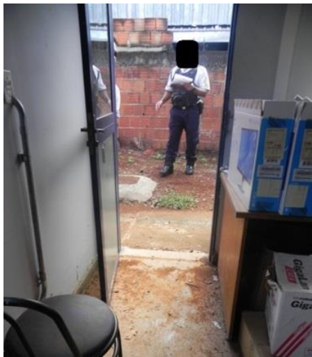
Figura 18 – Ambiente em má conservação – Falha na vedação que permitiu a entrada de água e terra na sala.
