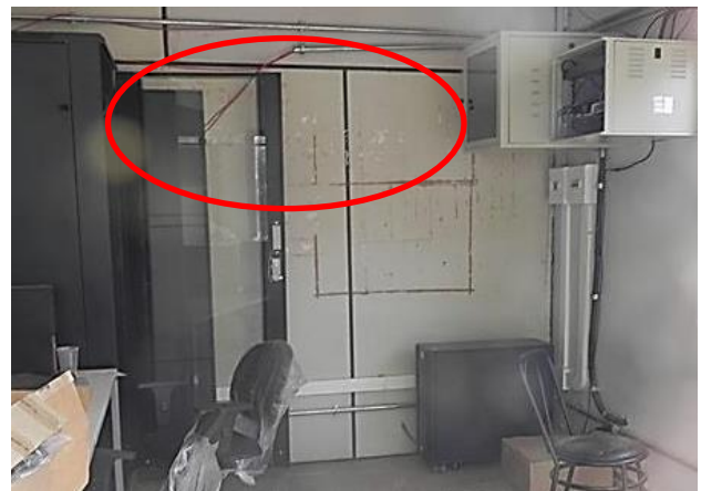
Figura 21 – Acabamento não concluído - Instalações elétricas e lógicas fora dos dutos de passagem.
