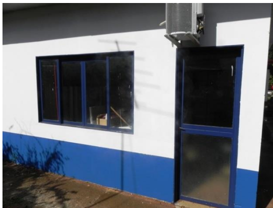
Figura 20 - Centro de Monitoramento entregue sem o sistema de identificação biométrica prevista.
