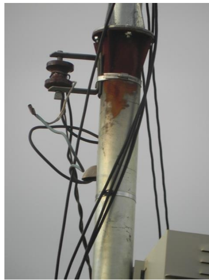
Figura 4 - Presença de oxidação em poste. Local: Samambaia, próximo ao Centro Urbano – quadra 302.
