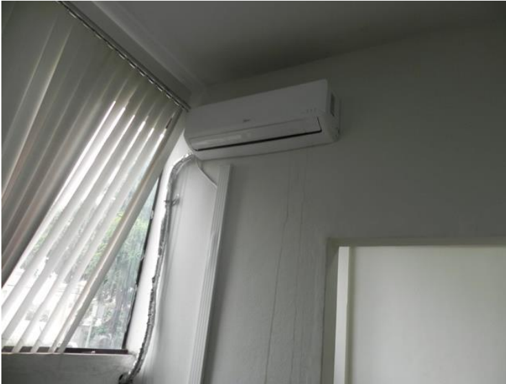
Figura 15 - Ambiente em má conservação - Vazamento de água do sistema de ar condicionado.
