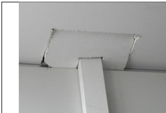
Figura 13 - Acabamento incompleto do forro de gesso do teto.
