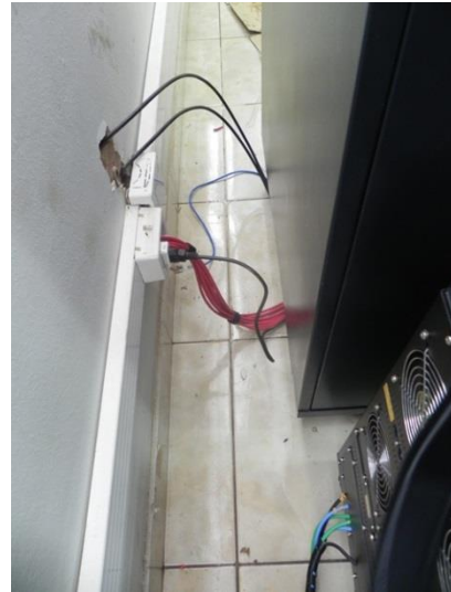
Figura 16- Acabamento das instalações do cabeamento elétrico e lógico não concluído.
