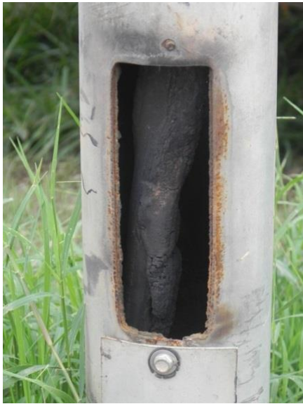
Figura 5 - Poste danificado. Local: Ceilândia, próximo a QNN 3 cj.B.
