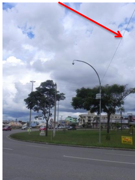
Figura 8 – Situação encontrada durante a inspeção realizada em Samambaia, em frente ao Hospital Regional – HRSam. Em substituição ao lançamento de cabo óptico subterrâneo previsto no projeto ao lado (traço vermelho), foi realizado lançamento aéreo.
