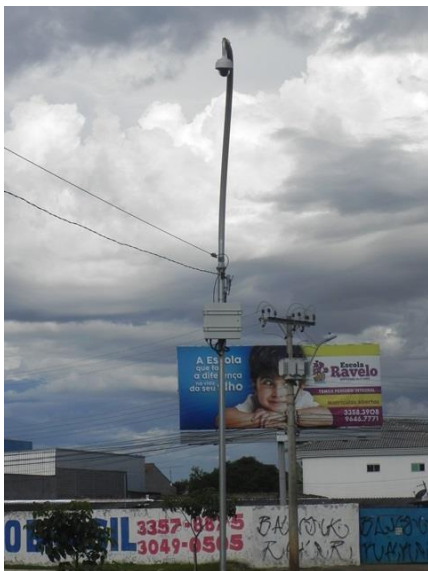
Figura 3 - Poste apresentando deformação. Local: Samambaia, próximo a QR 516.
