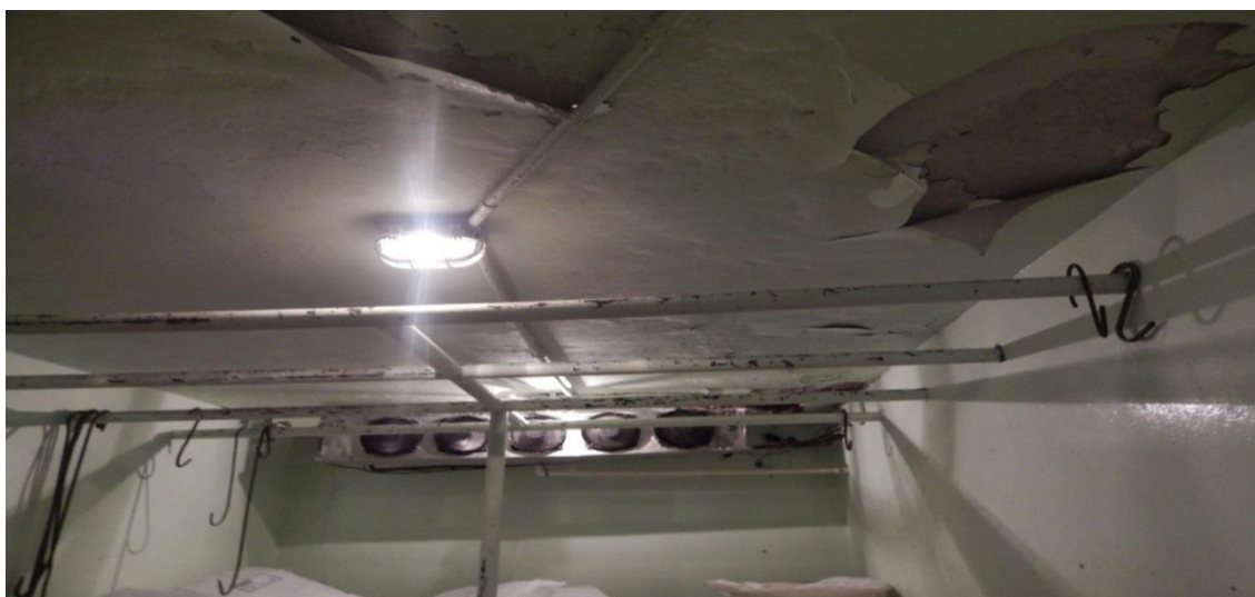
Foto 4 - Ausência de manutenção da pintura da Câmara frigorífica.
