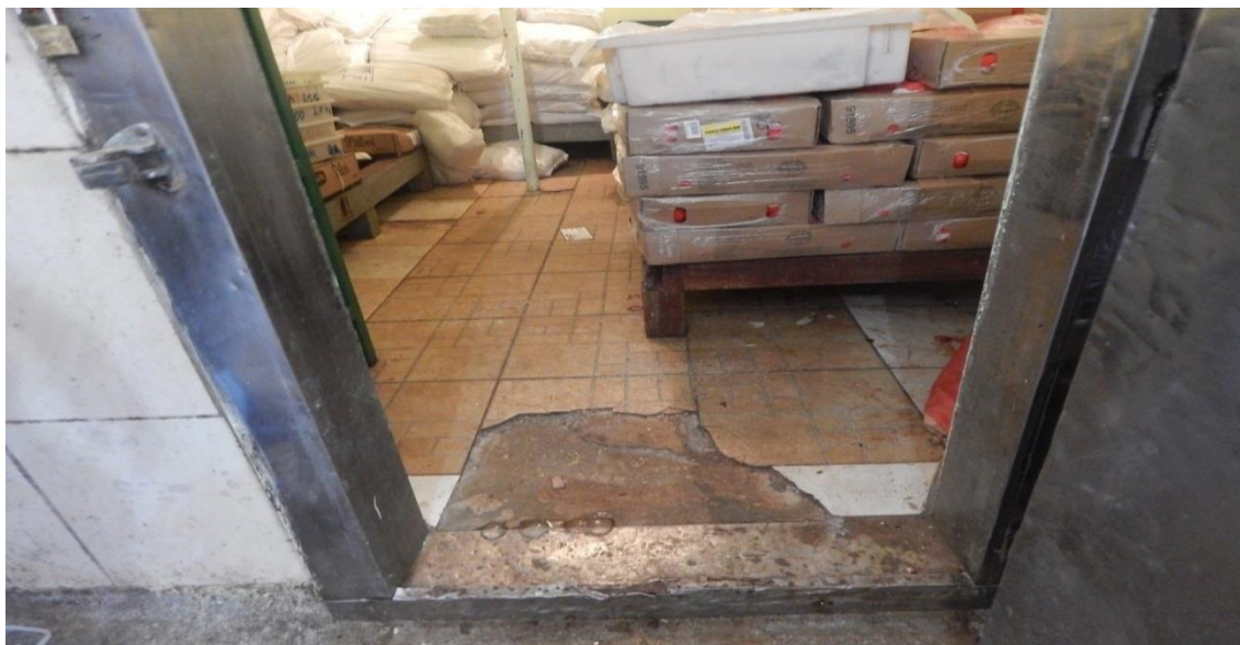
Foto 3 – Câmara frigorífica da Unidade de Nutrição Animal apresenta piso danificado.
