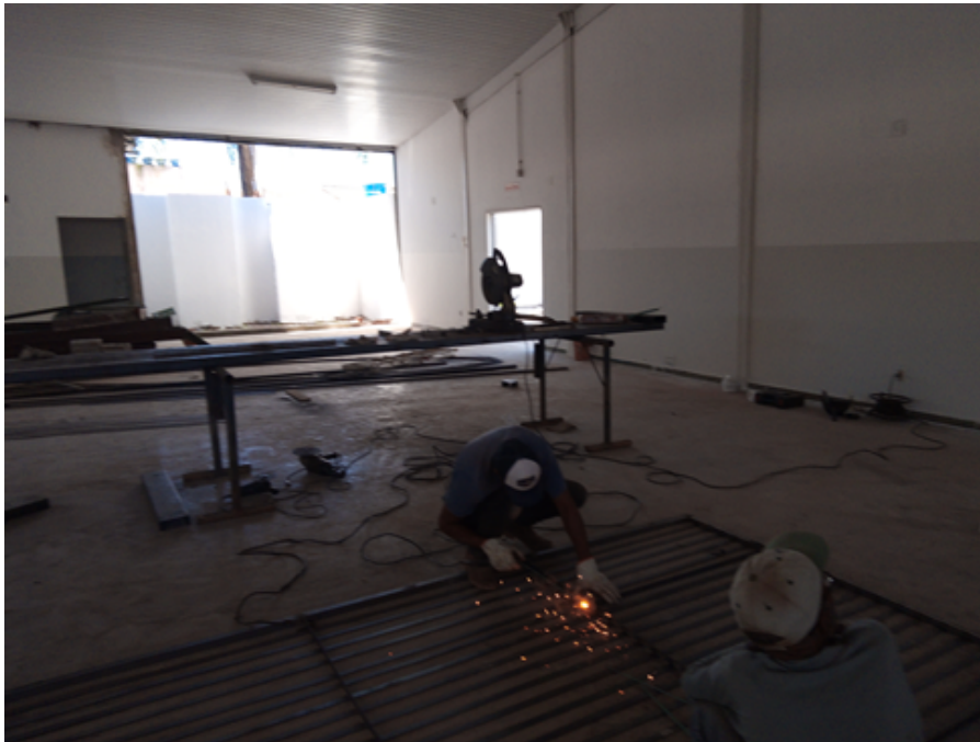
Imagem 1 - Reforma do Salão Comunitário - Ausência de projeto e instalação de equipamentos de segurança de prevenção a combate a incêndio
