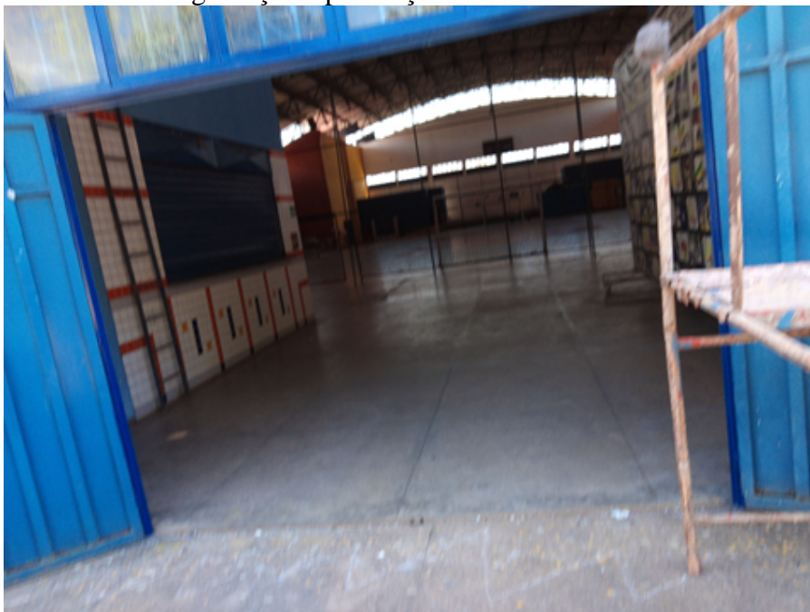
Imagem 2 - Reforma do Ginásio de Múltiplas Atividades - Ausência de projeto e instalação de equipamentos de segurança de prevenção a combate a incêndio
