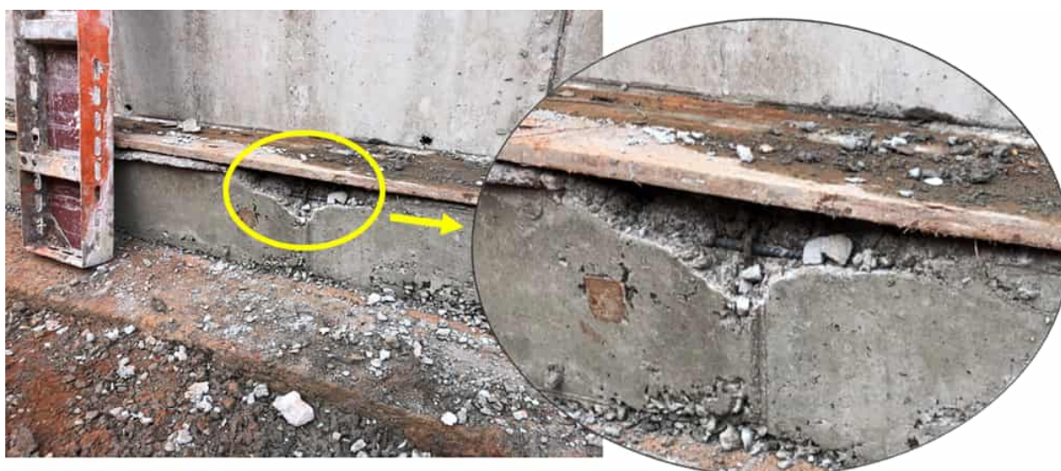
(c) Exposição de armaduras.
