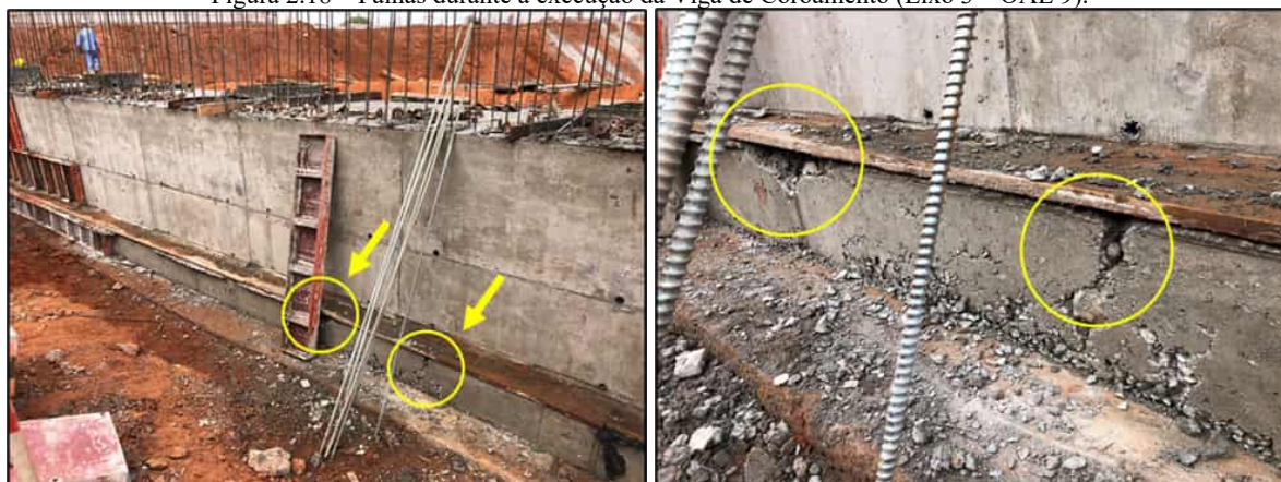
(a) Vazios no elemento estrutural (bicheiras).
