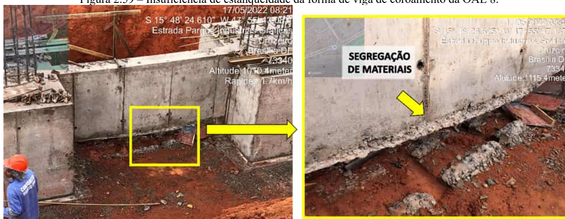
Figura 2.59 – Insuficiência de estanqueidade da fôrma de viga de coroamento da OAE 8.
