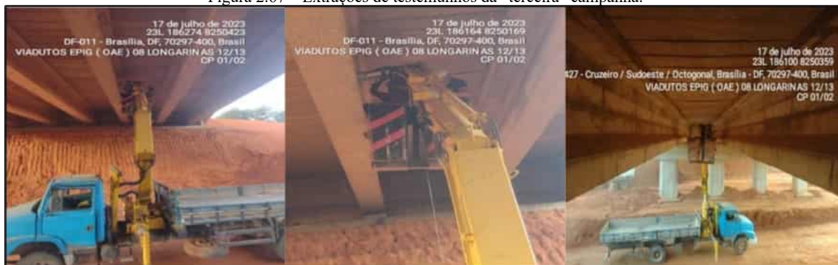
(a) Viga Longarina VL12 da OAE 8. (b) Viga Longarina VL12 da OAE 8. (c) Viga Longarina VL12 da OAE 8.
