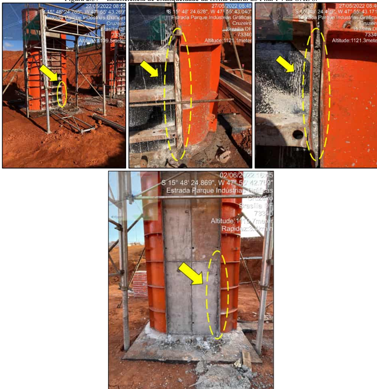
Figura 2.57 – Insuficiência de estanqueidade da fôrma lateral do Pilar P4 da OAE 8.
