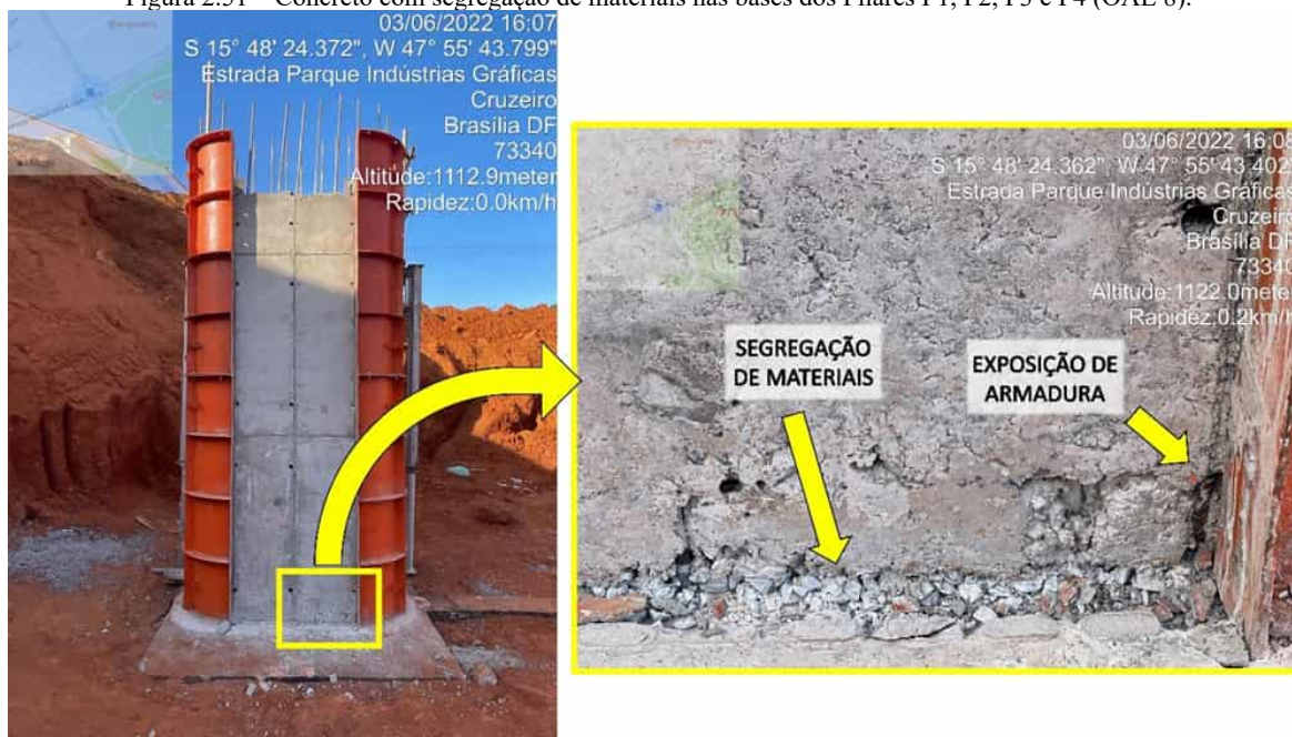
Figura 2.51 – Concreto com segregação de materiais nas bases dos Pilares P1, P2, P3 e P4 (OAE 8).
