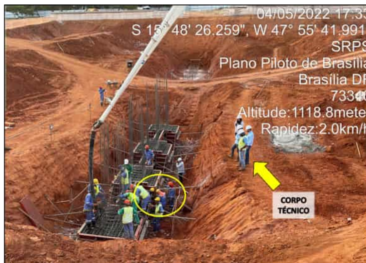
(c) Constatação da falha pelo corpo técnico.
