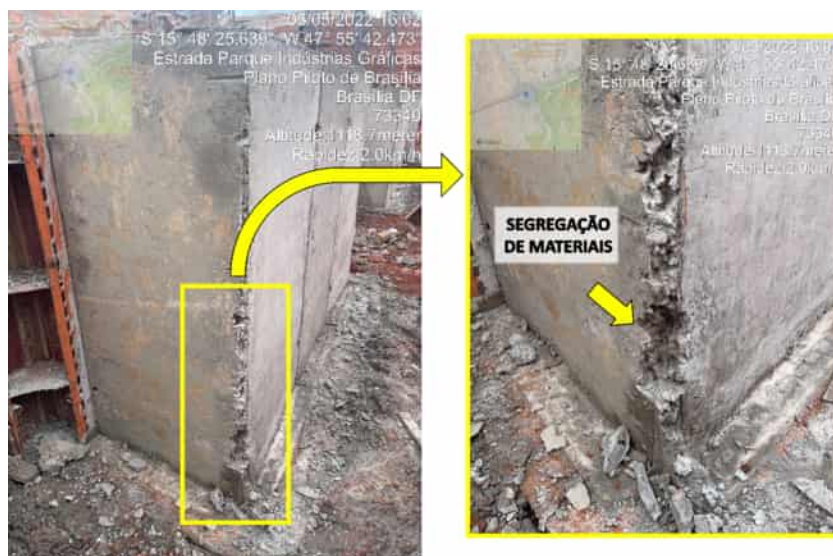
(d) Falha na quina do elemento.
