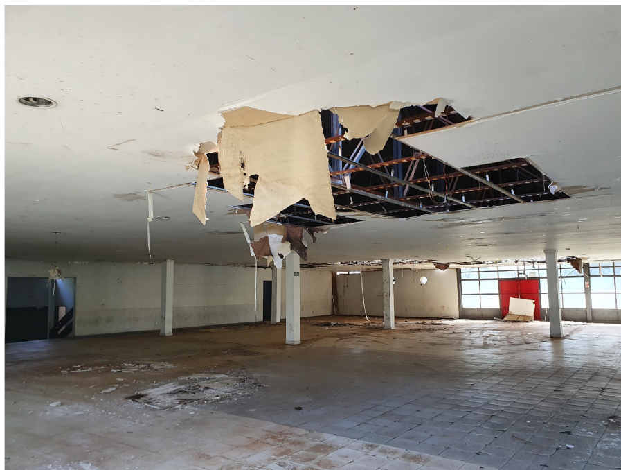
Imagem 6: Salão de Múltiplas Funções apresentando diversos problemas de manutenção com interdição da Defesa civil.
