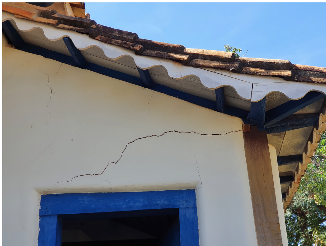
Imagem 8: Rachadura importante em parede da Igreja São Sebastião (prédio próprio histórico da Região Administrativa de Planaltina).
