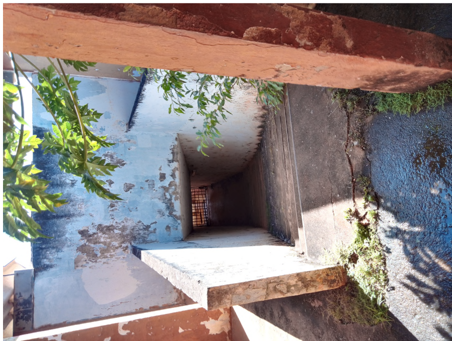
Imagem 4: Entrada e saída dos vestiários apresentando infiltrações, falhas de estrutura, infiltrações e falta de manutenção.
