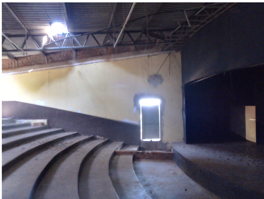
Imagem 5: Auditório localizado na Sede Administrativa interditado pela Defesa Civil em virtude das precárias condições de manutenção.
