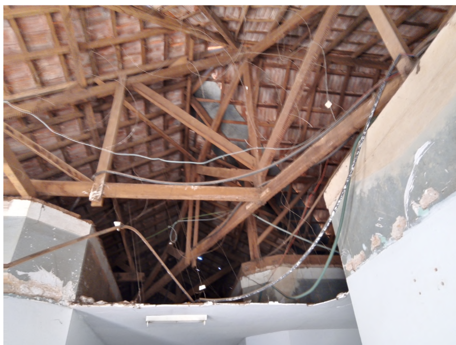
Imagem 7: Prédio da Prefeitura Velha com avarias no telhado.
