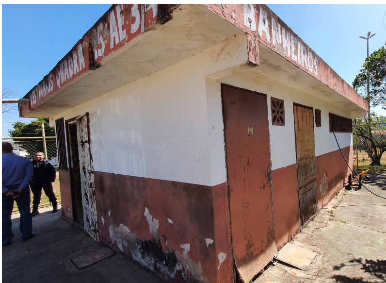
Imagem 18: precário estado de conservação da pintura no Módulo da Quadra 15.
