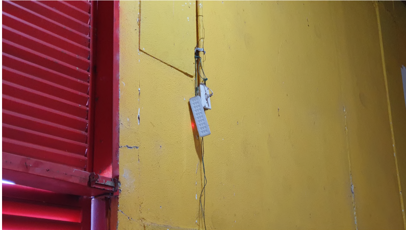
Imagem 12: luminária de emergência instalada de forma precária no Ginásio de Esportes.
