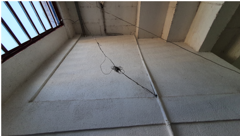
Imagem 13: fiação exposta no Ginásio de Esportes.
