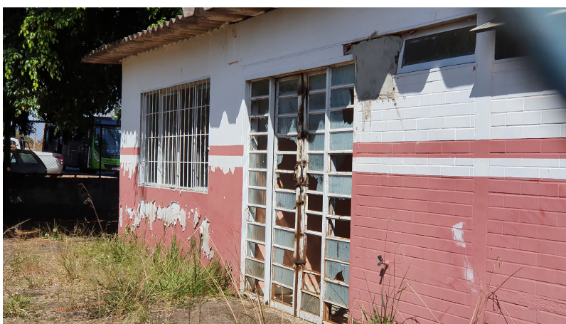
Imagem 19: vidros quebrados e precário estado da pintura no Módulo da Quadra 15
