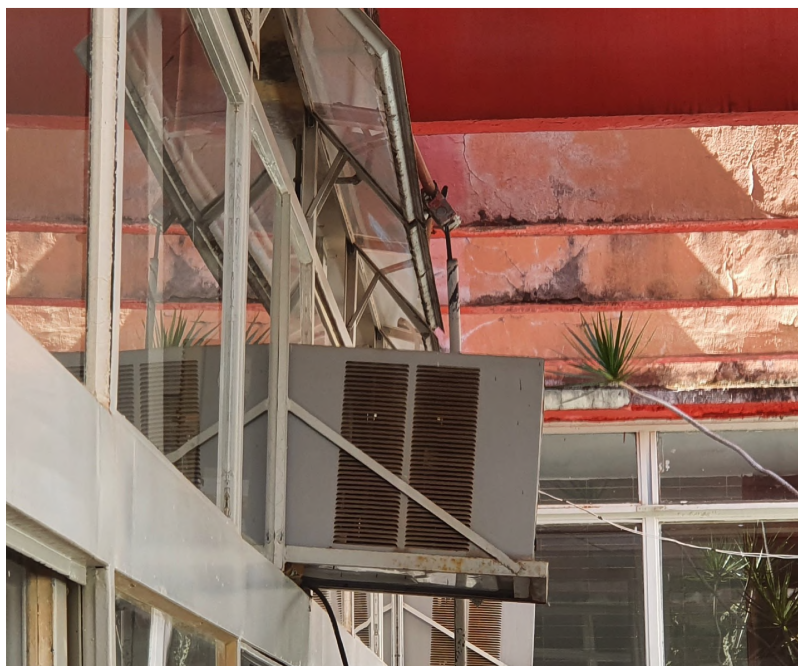
Imagem 4: fiação elétrica exposta na sede da RA -V
