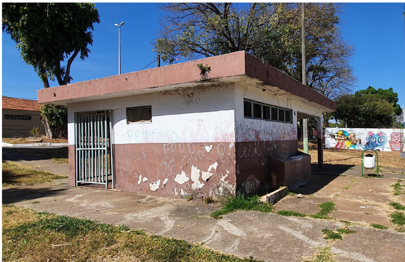
Imagem 16: módulo da Quadra 6 com infiltração e precário estado de conservação da pintura.
