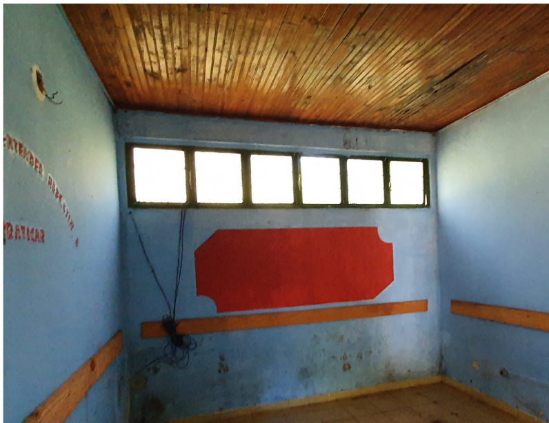
Imagem 14: apresenta infiltração no forro e fiação exposta na Casa do Ribeirão.
