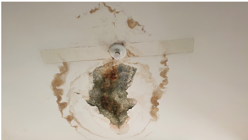
Imagem 3: infiltração no teto junto ao bocal de luz na sede da RA-V
