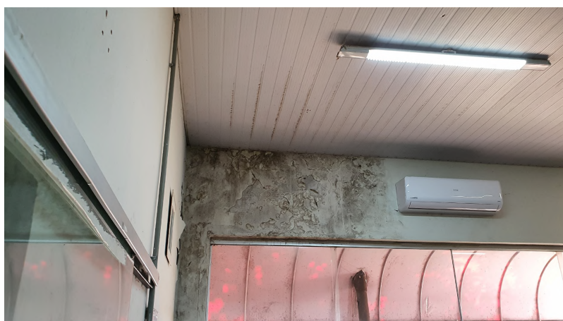
Imagem 5: infiltração na parede da biblioteca
