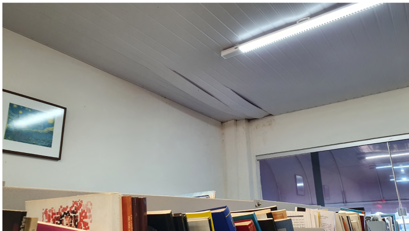
Imagem 6: forro da biblioteca com risco de queda.
