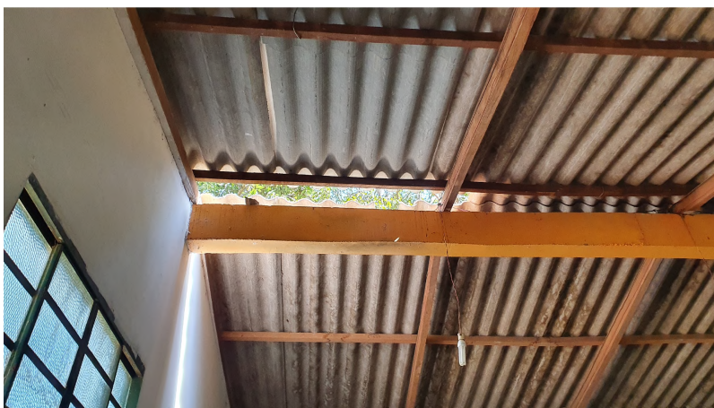
Imagem 15: telhado necessitando de reparos na Casa do Ribeirão.
