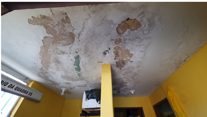
Imagem 17: infiltração no teto do Módulo da Quadra 15
