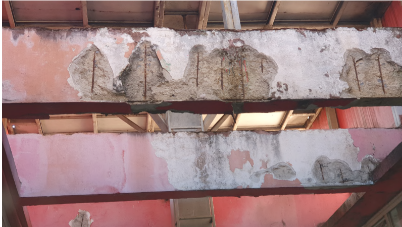
Imagem 2: vigas em precário estado de conservação na sede da RA-V
