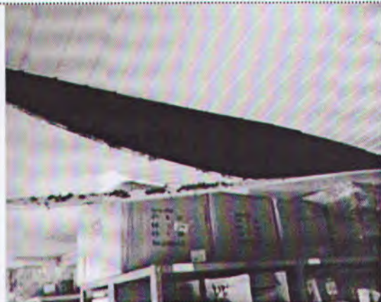
Fig. 1 – Queda do forro em itens estocados e possível exposição a animais daninhos
