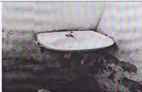
Fig. 5 – Problemas hidráulicos e sujeira
