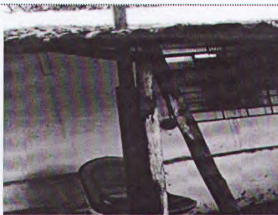
Fig. 8 – Escoramento indevido e em deterioração, possibilitando ocorrência de acidentes
