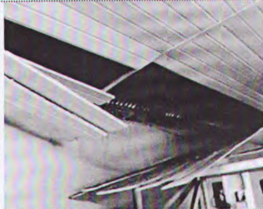
Fig. 2 – Queda do forro e exposição da rede elétrica
