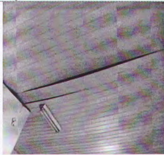
Fig. 2 – Forro do Salão Comunitário com avarias com risco de queda
