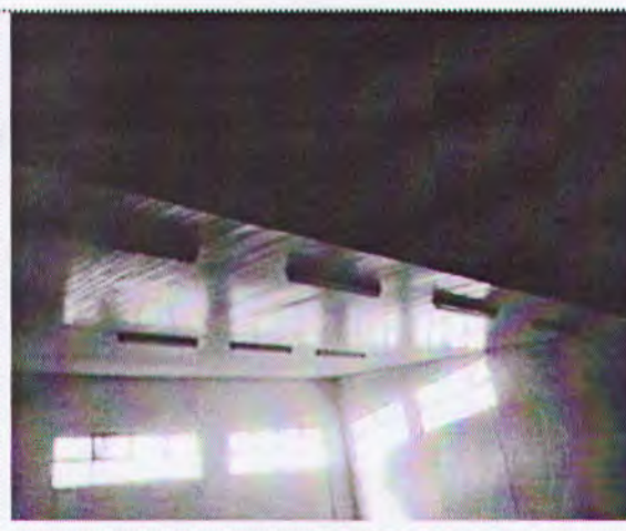
Fig. 4 – Iluminação precária aumentando a insegurança (lâmpadas queimadas)
