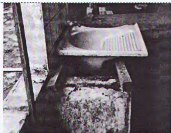
Fig. 7 – Tanque quebrado possibilitando ocorrência de acidentes
