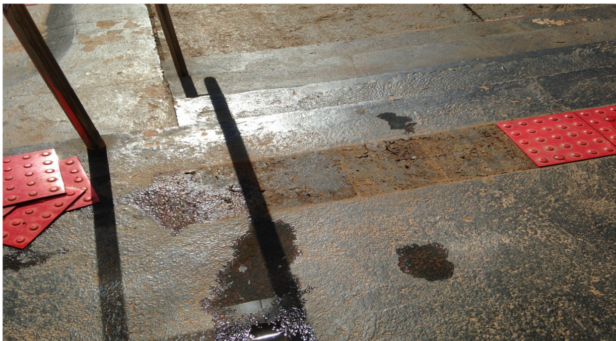
Fotografia 2 – Falha em Instalações de Acessibilidade
