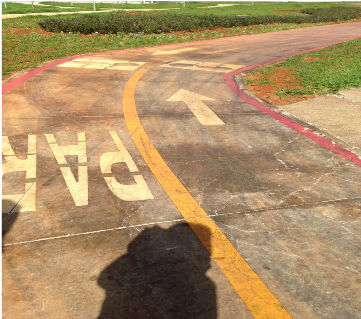
Fotografia 1 – Trincas em Pavimento
