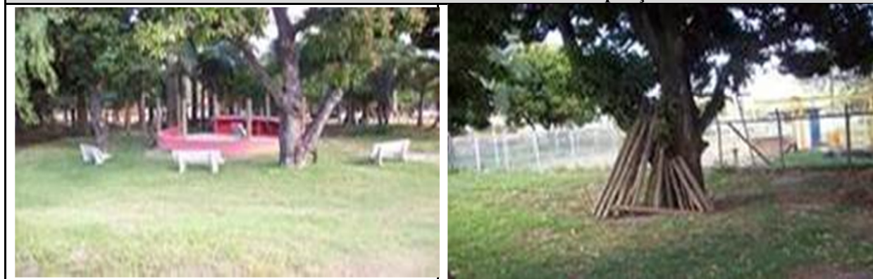
O telhado desmoronou e ainda não houve sua reposição
