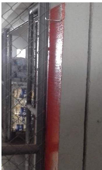
Ausência de extintor de incêndio
