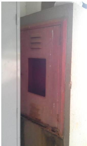
Caixa de hidrante sem mangueira
