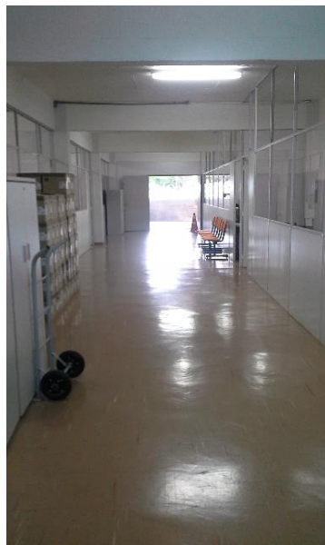
Corredor sem extintor de incêndio
