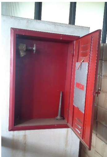
Caixa de hidrante sem mangueira
