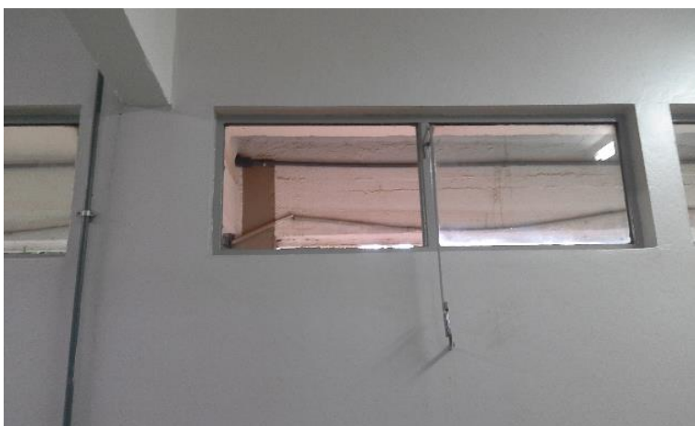
Janela sem vidro e sem grade
