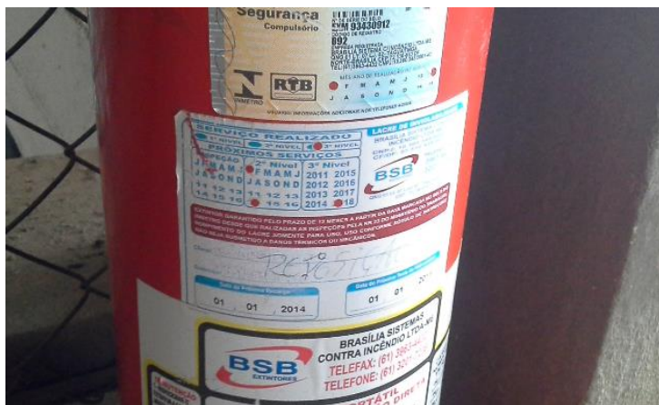
Extintor de incêndio com validade expirada
