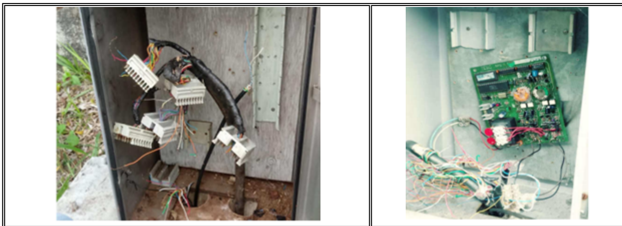
Figura 2 - Controladores e gabinetes com vandalismo
