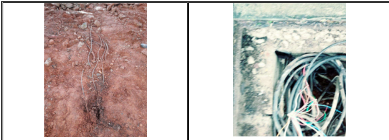
Figura 1 - Cabos de comunicação expostos sem condutores (duto corrugado) e aterramento
