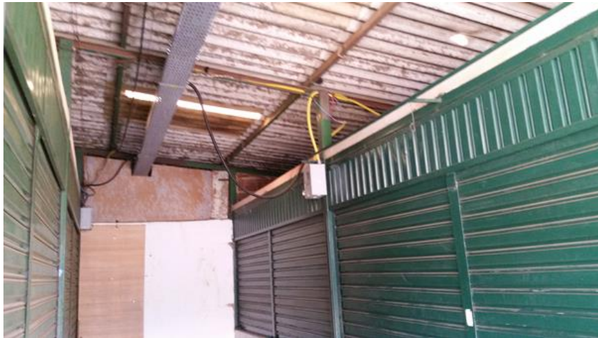
Foto 1: instalação elétrica da Feira da Guariroba apenas realizada parcialmente e não está funcionando. Foto em 3/10/2019.
