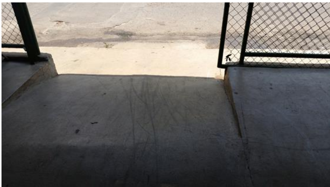
Foto 3: Rampa de acessibilidade com inclinação superior a 8,33% e ausência de sinalização tátil e ainda com ligação direta com a via pública.
