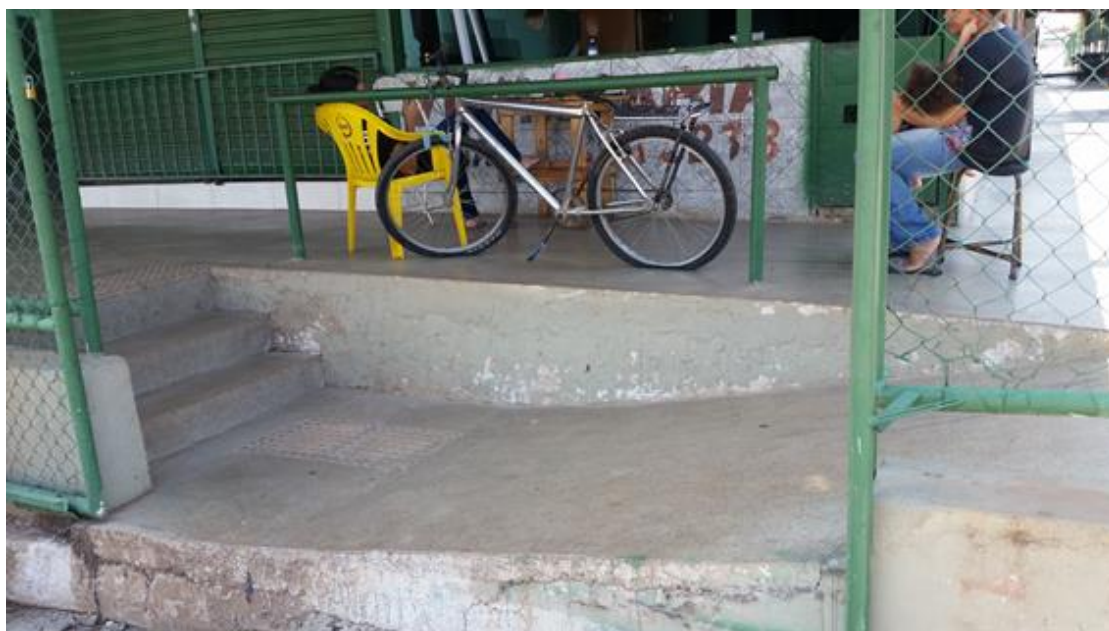
Foto 4: Rampa de acessibilidade com inclinação superior a permitida pela norma, ausência de sinalização tátil e ainda apresentando desnível acentuado denominado "barreira urbanística".
