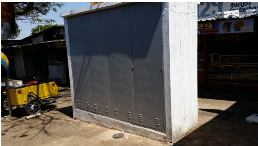
Foto 2: quadro de energia da Feira da Guariroba em Ceilândia construído visando a instalação da nova rede de baixa tensão. Equipamento ainda não utilizado. Foto em 3/10/2019.
