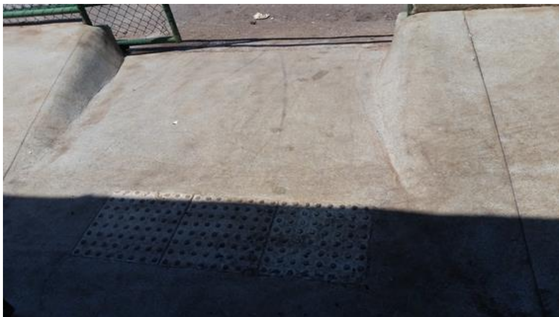
Foto 5: Rampa de acessibilidade apresentando desnível acentuado em desacordo com as normas vigentes com riscos a portadores de deficiências, idosos e demais usuários.
