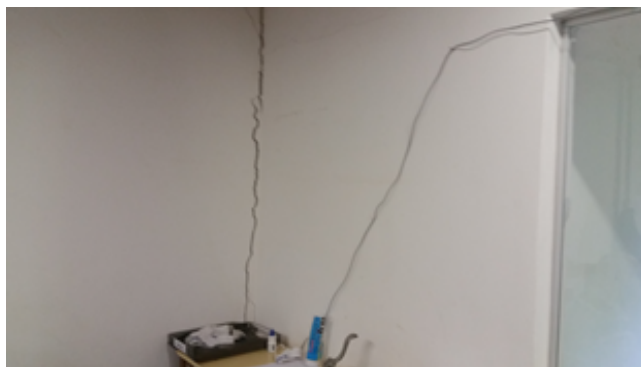
Foto 6: Rachadura na parede e fiação elétrica exposta em sala ocupada atualmente por servidores da RA-XV.
