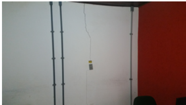
Foto 5: Rachadura importante em parede do prédio da antiga sede.
