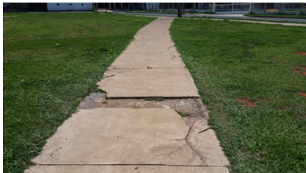
Foto 1: Passeio da Praça da Bíblia apresentando rachaduras no concreto das calçadas e baixa qualidade dos materiais empregados.
