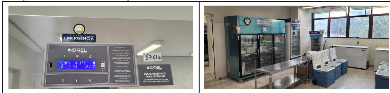
Figura 8 - Instalações da CRF - Área de armazenamento de Imunobiológicos - Câmaras Refrigeradas e Caixas de Transporte.
